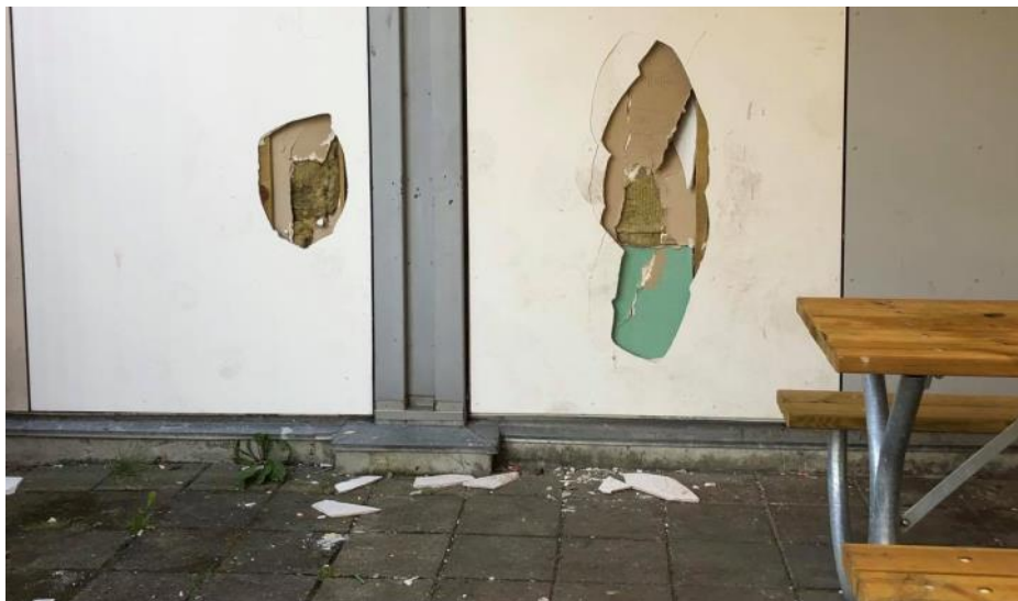
Ødelagt facade ved unges tilholdssted på Egebjergskolen. Foto: Charlotte Holtermann
